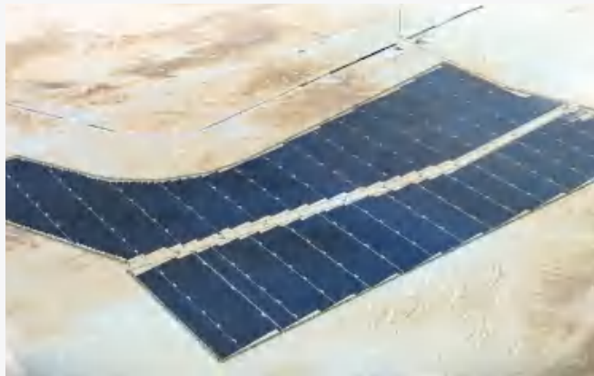
Al Dhafra PV Project
